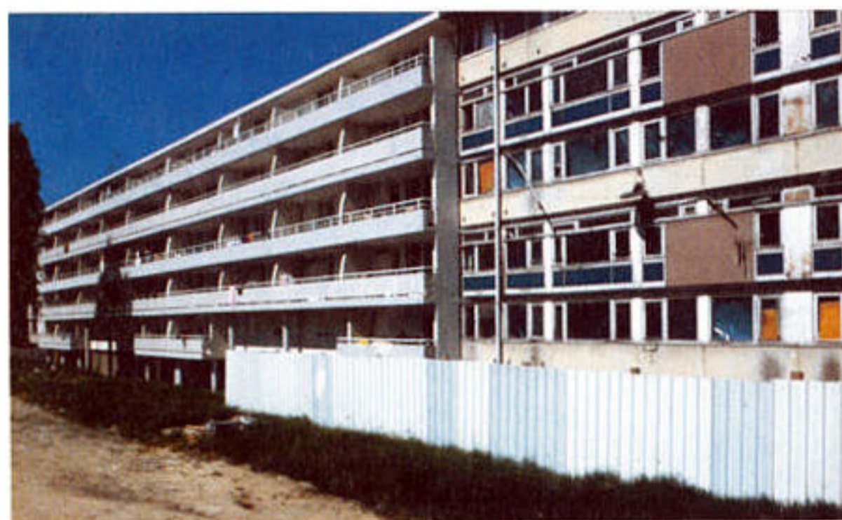
La barre C, avant et après réhabilitation. Outre les travaux de rénovation habituels (réfection de la plomberie, de l'électricité...), les logements se voient adjoindre des balcons avec création de portes-fenêtres dans les séjours. Coût de la réhabilitation du bâti (439 logements conservés): 15,5 millions d'euros.
